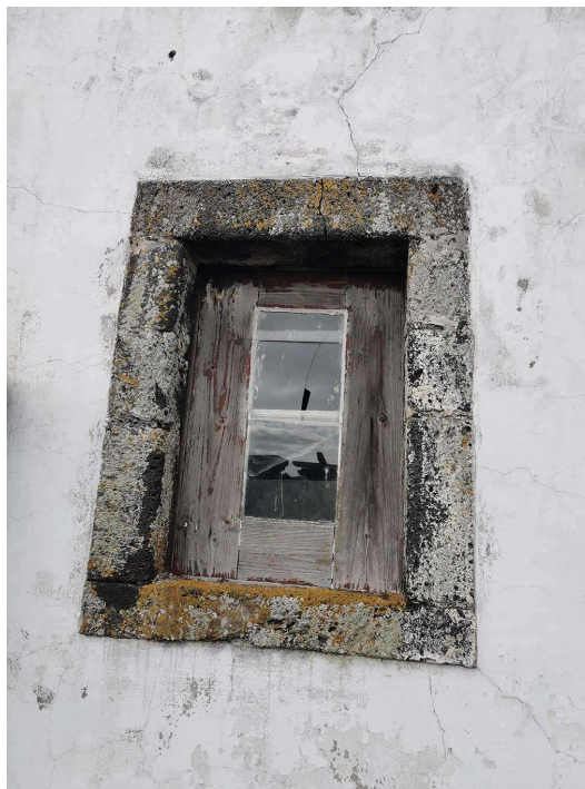
Fot. 6 - Presença de partículas soltas e agregadas
