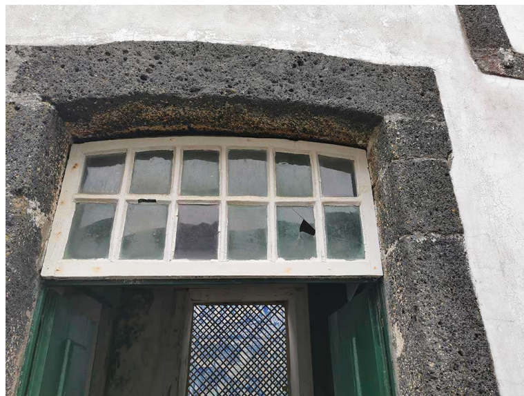
Fot. 8 - Observação de juntas abertas
