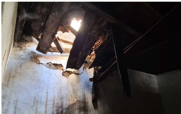
Fot. 1 - Desagregação da massa de preenchimento de uma das paredes
