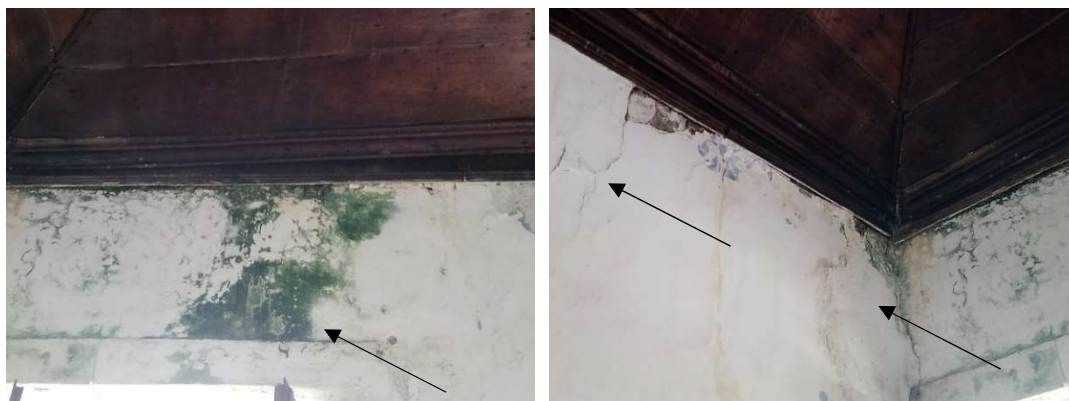
Fot. 2 e 3- Identificação de presença de fungos, macro fissuras, destaque da camada pictórica, desnivelamentos e “bolsas de ar”.
