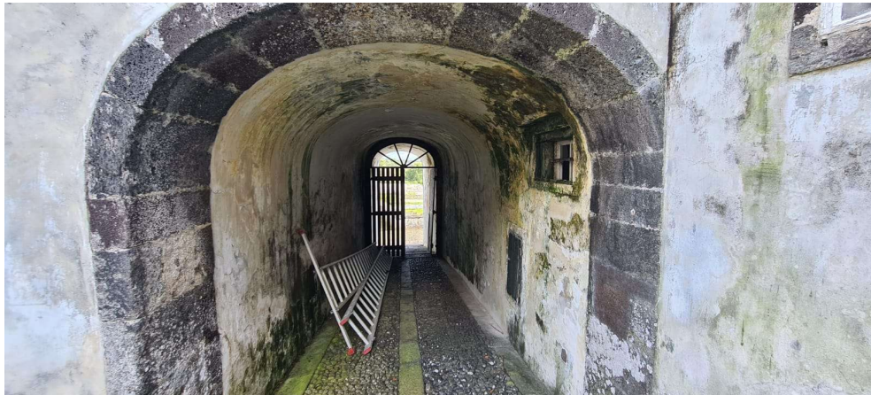
Fot. 7 - Presença de incrustações calcárias
