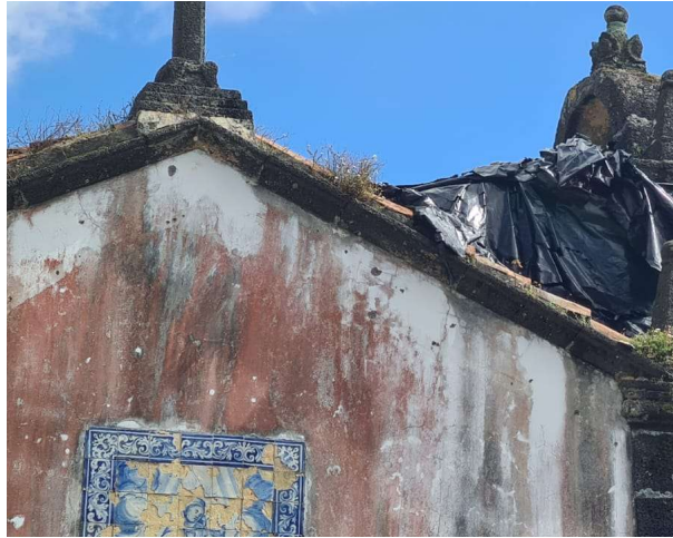
Fot. 15 - Delaminação do vidrado
