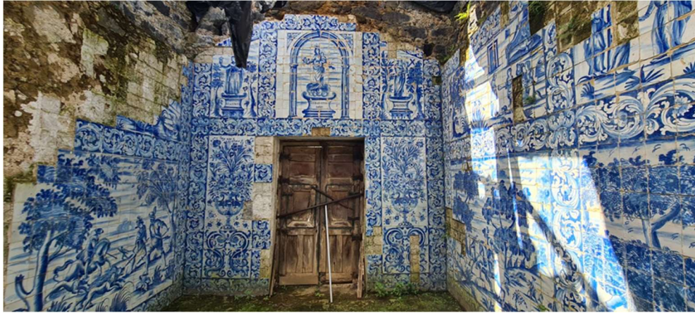
Fot. 13 - Azulejos com fraturas, presença de ataque biológico.
