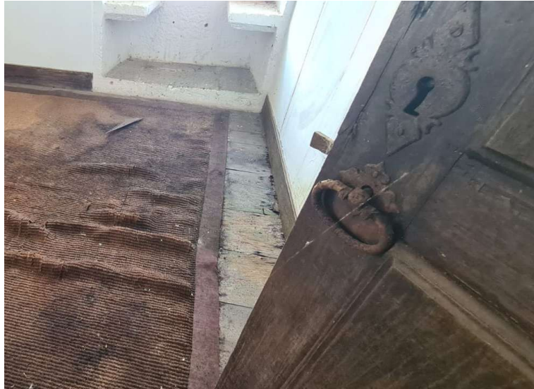
Fot. 11 - Presença de oxidação num s batente e espelho de fechadura
