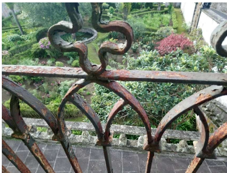
Fot. 10 - Pormenor de destaque da tinta e presença de oxidação dos varandins
