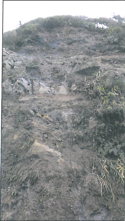
Figura 3- Cicatriz da instabilidade onde se pode observar a constituição geológica do talude.
