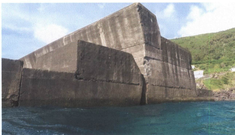
Fig.32 – Falha no bloco do topo do muro de remate do prisma de enrocamento
