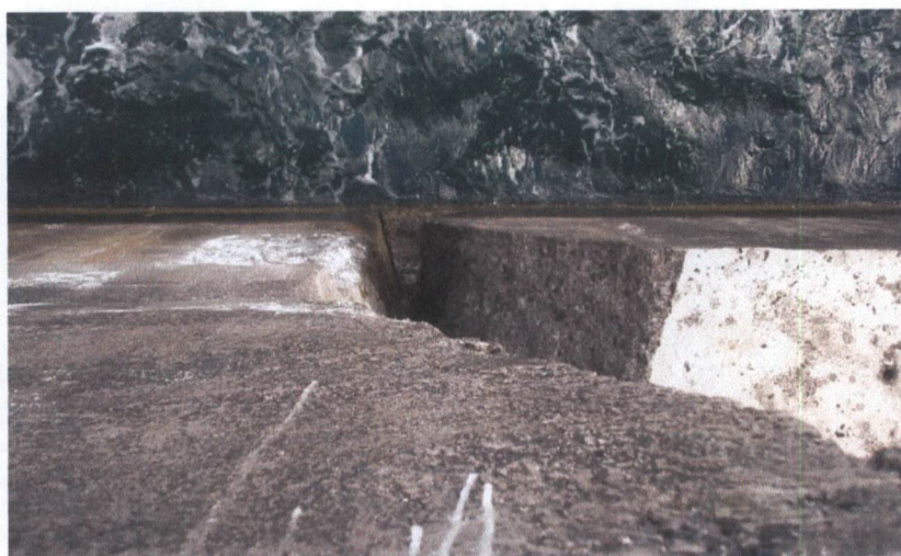
Fig.34 – Falha no bloco do topo do muro de remate do prisma de enrocamento
