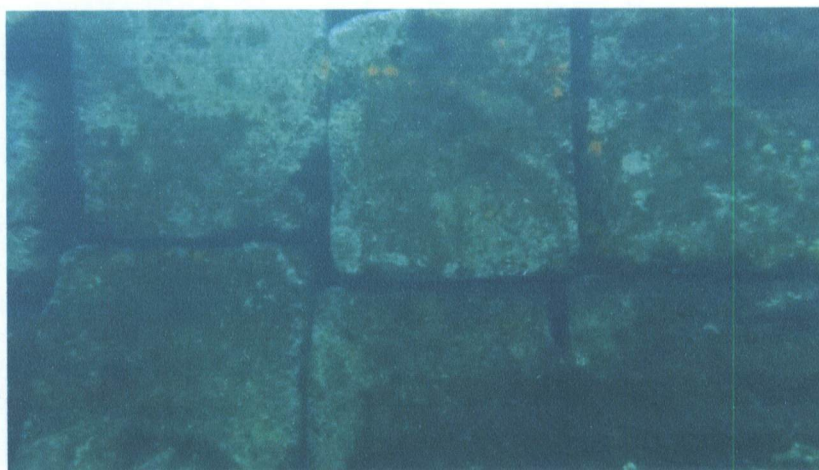
Fig.22 – Juntas horizontais desencontradas
