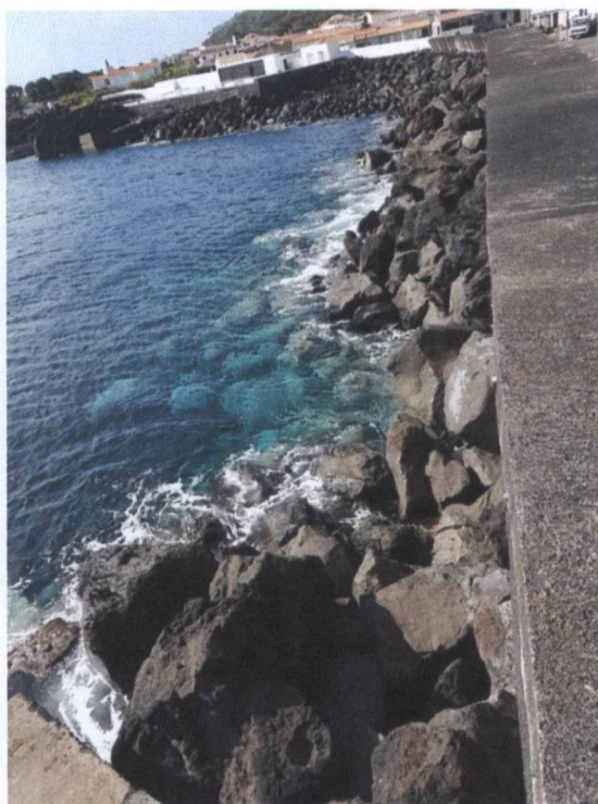
Fig.36 – Falha no prisma de enrocamento junto ao Muro de remate
