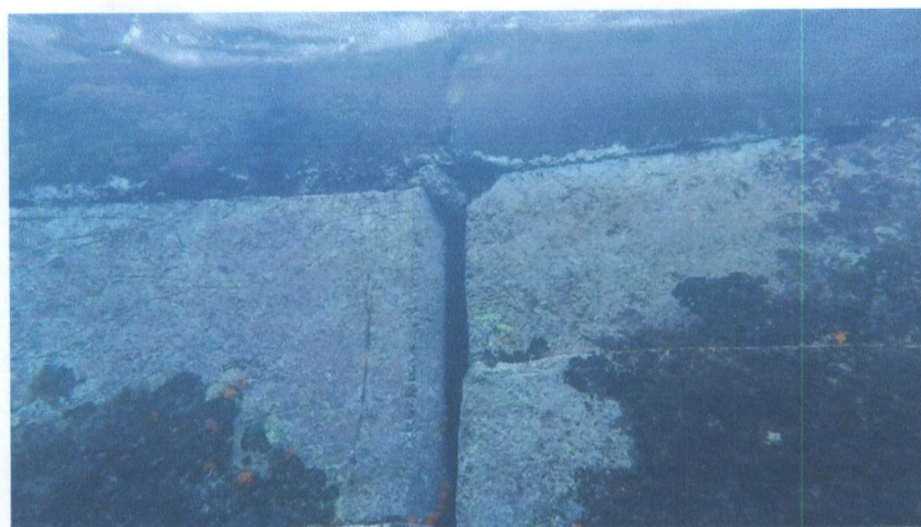
Fig.26 – Junta entre a segunda e terceira colunas de aduelas do quarto troço
