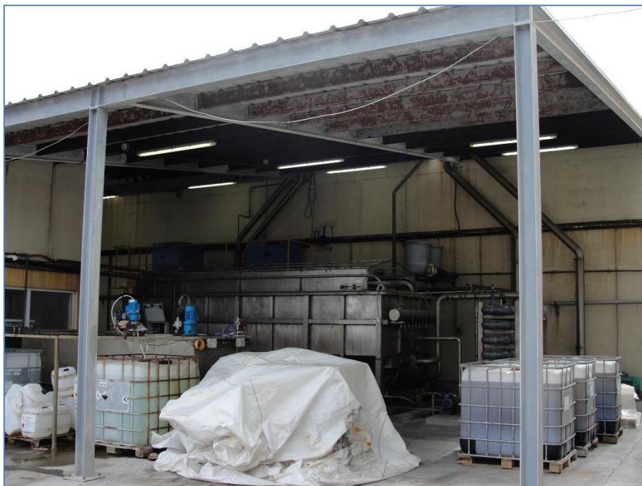
Figura 2.3: Tratamento químico (flotador).
