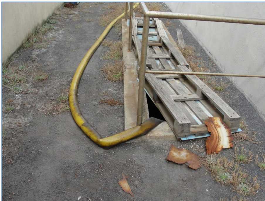
Figura 2.3: Tubo de descarga de lamas do flotador no meio recetor.
