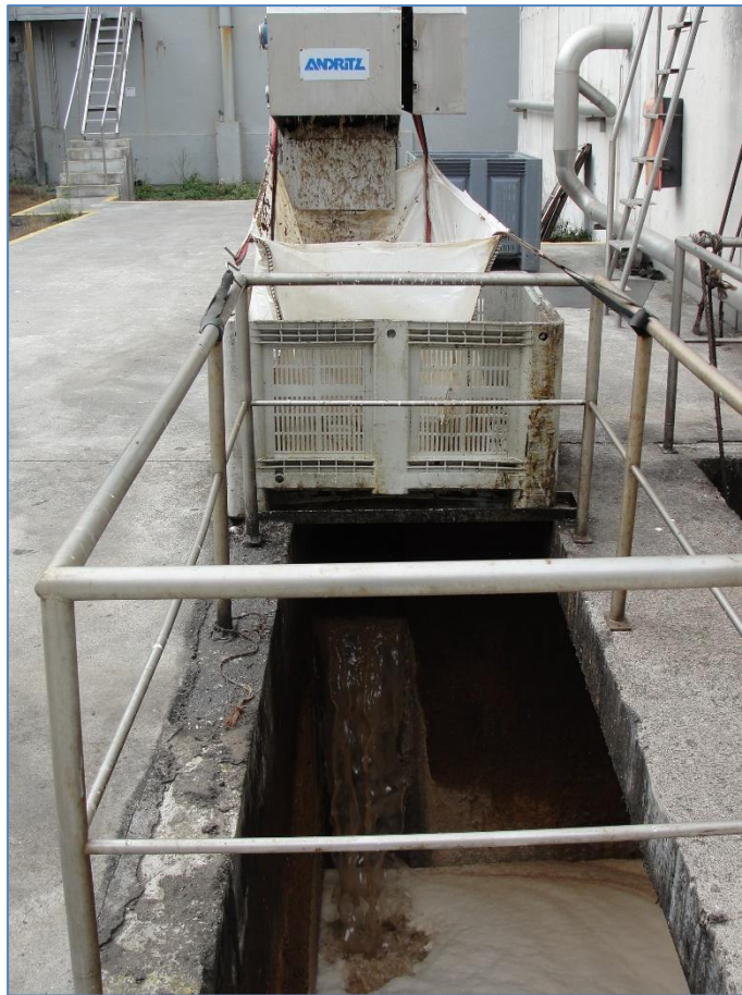
Figura 2.2: Gradagem do efluente à entrada da ETARI.
